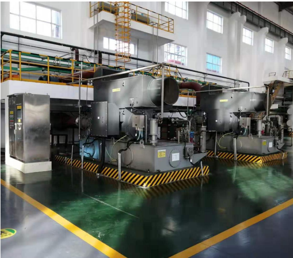
安装 CAS 隔声墙体后的隔声房外约 70 分贝
